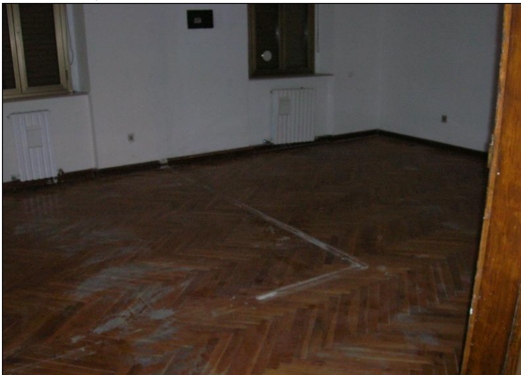
Foto 2 - stato manutentivo pavimentazione camera.
