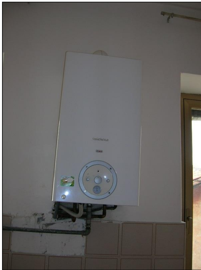
Foto 7 - caldaia dell'impianto di riscaldamento autonomo a metano.
