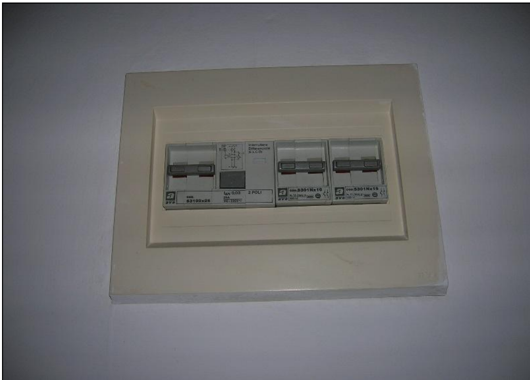
Foto 6 – quadro elettrico dell'unità immobiliare.
