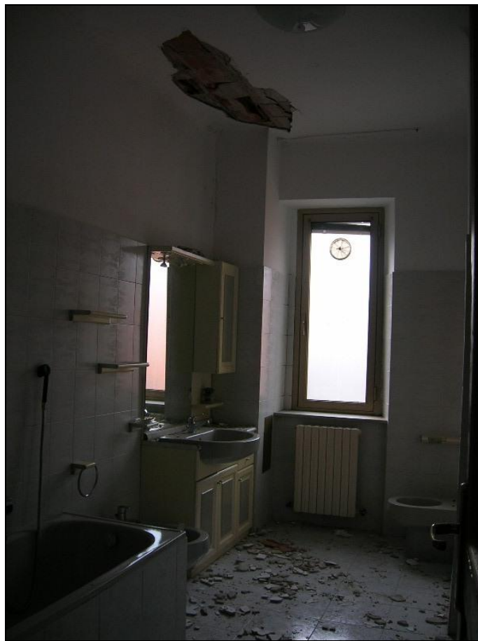
Foto 3 - stato manutentivo pavimentazione del bagno.
