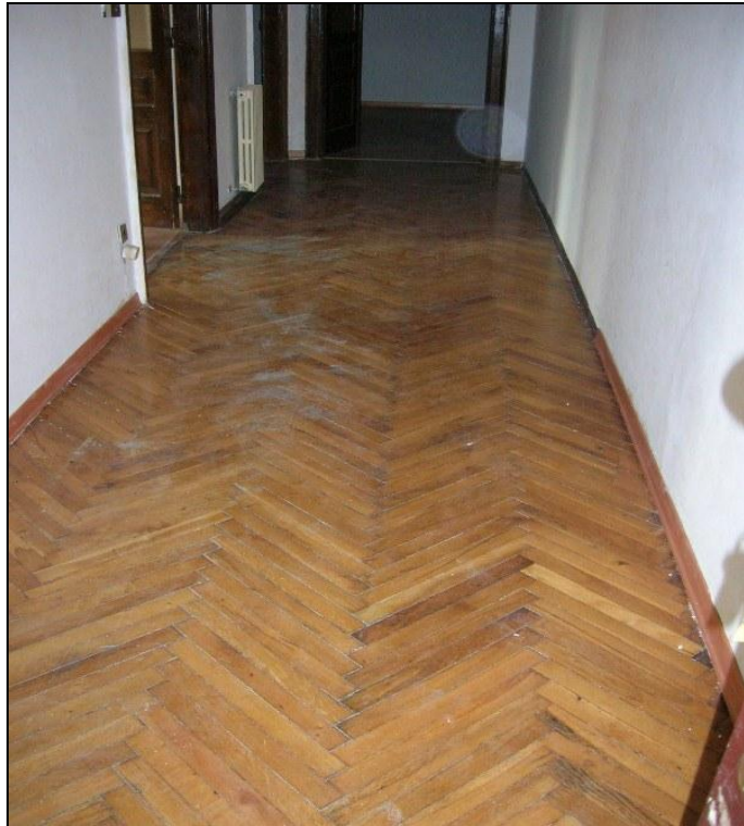
Foto 1 - stato manutentivo pavimentazione dell'ingresso /corridoio
