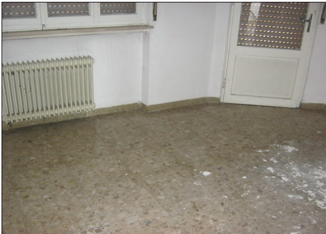
Foto 1 - stato manutentivo pavimentazione del soggiorno.
