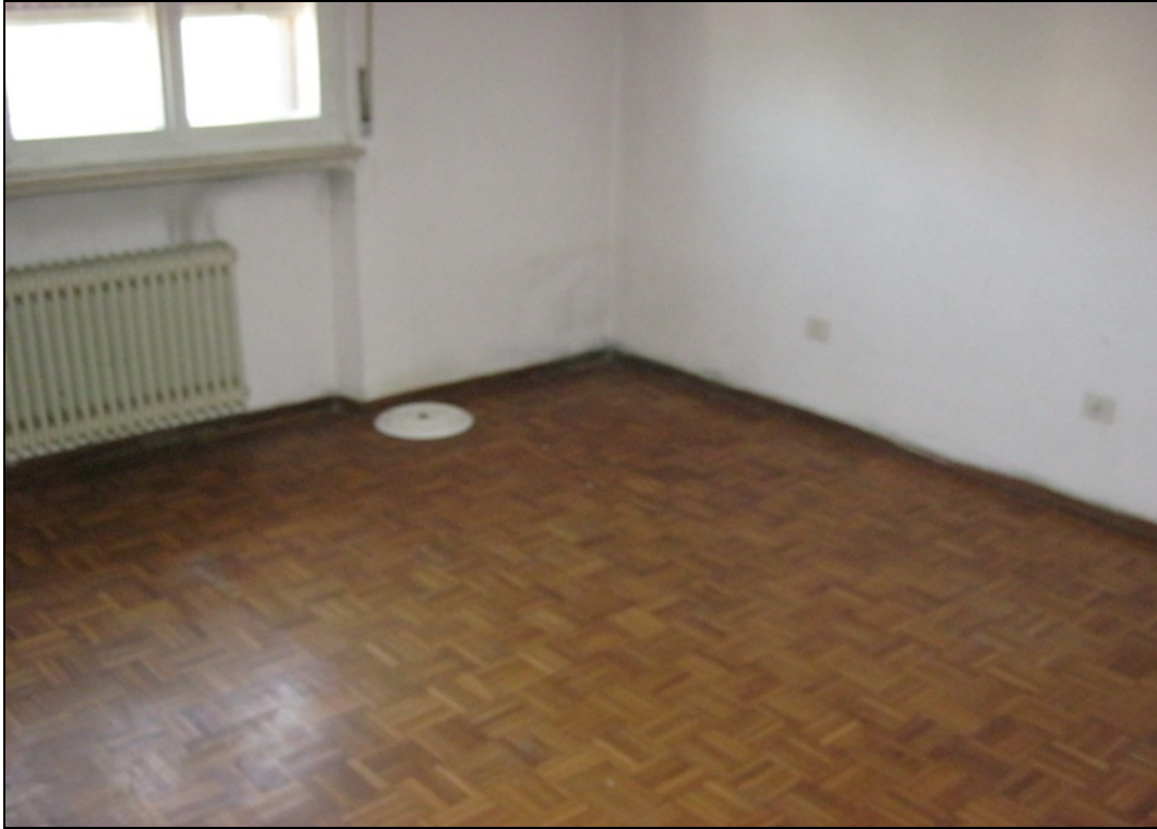
Foto 3 - stato manutentivo pavimentazione delle camere.
