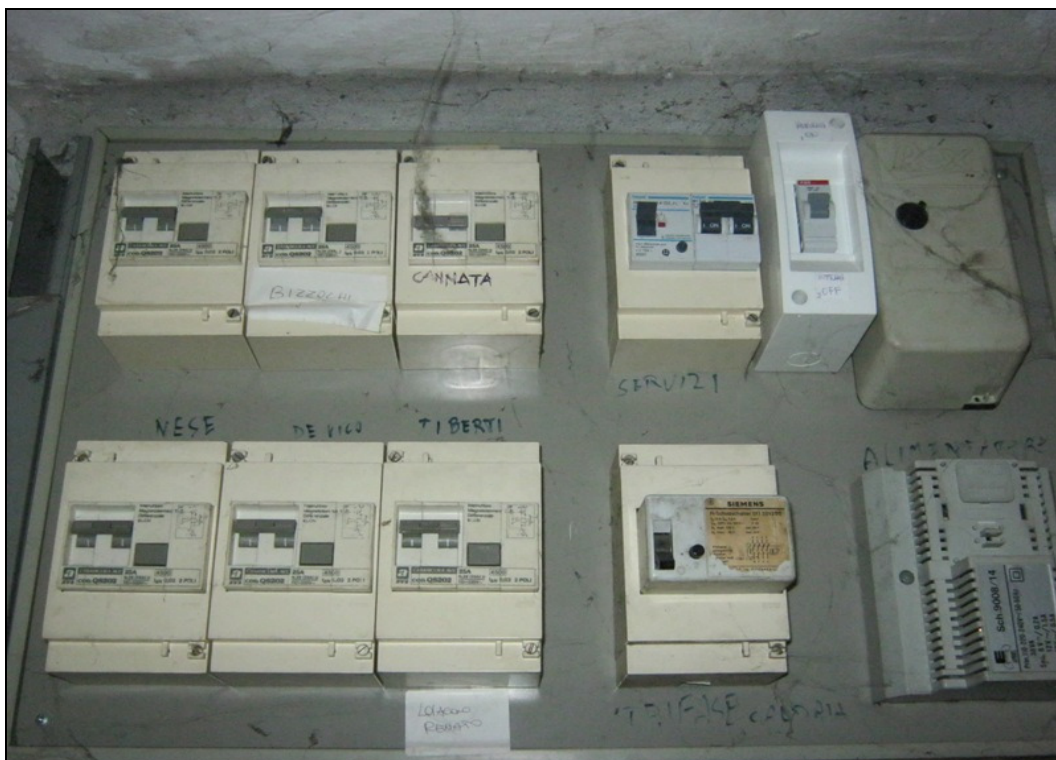
Foto 6 – quadro elettrico unità immobiliare.
