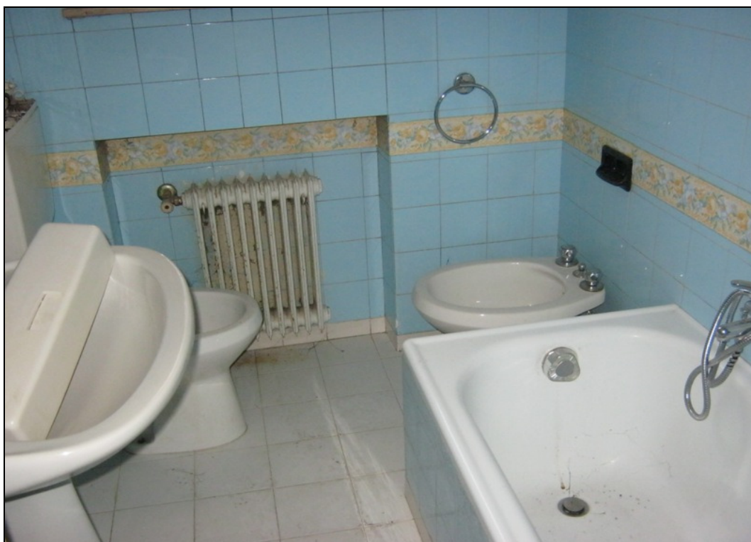
Foto 2 - stato manutentivo pavimentazione del bagno.
