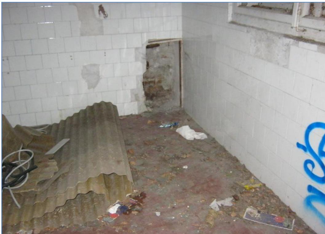
Foto 1 - stato manutentivo pavimentazione del soggiorno.
