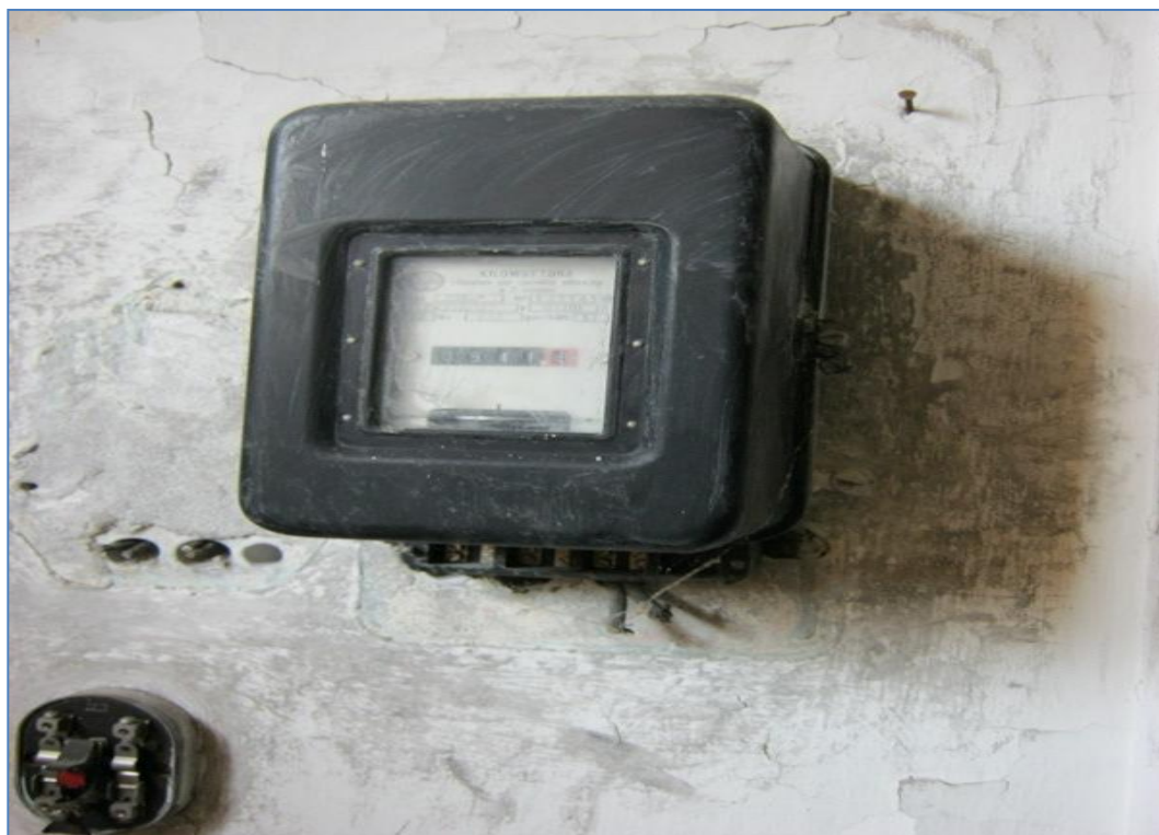
Foto 6 – quadro elettrico unità immobiliare.
