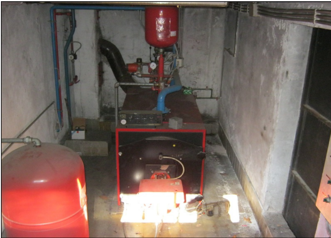
Foto 7 – caldaia centralizzata a gasolio.
