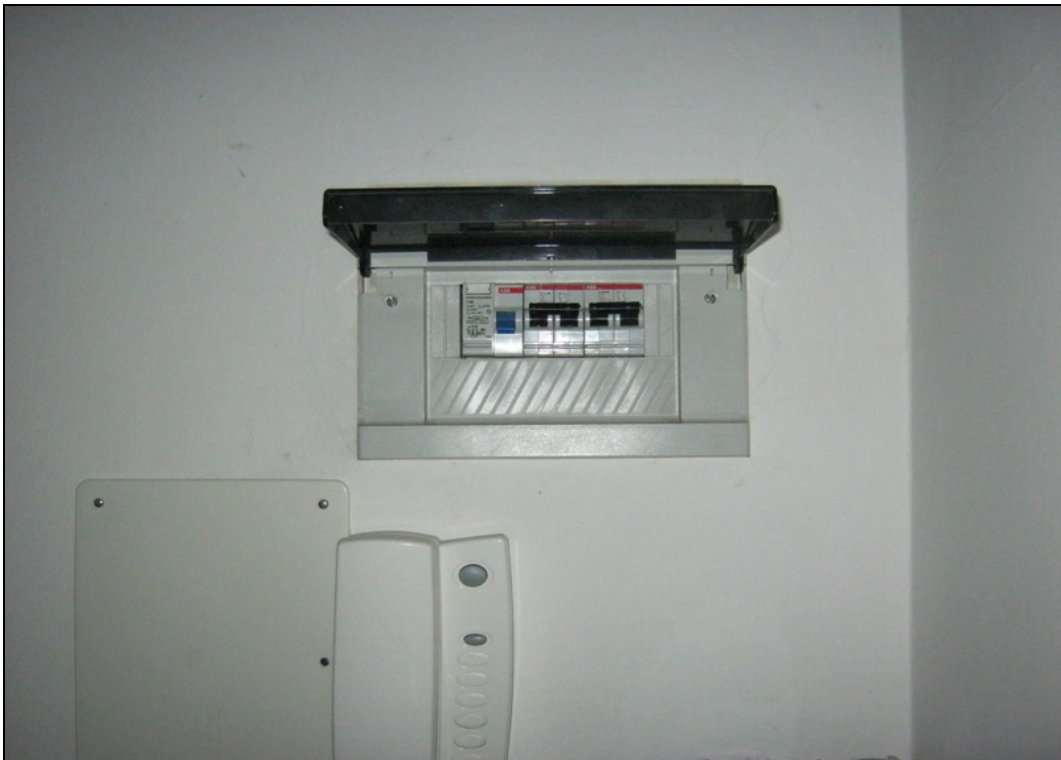
Foto 6 - quadro elettrico unità immobiliare.
