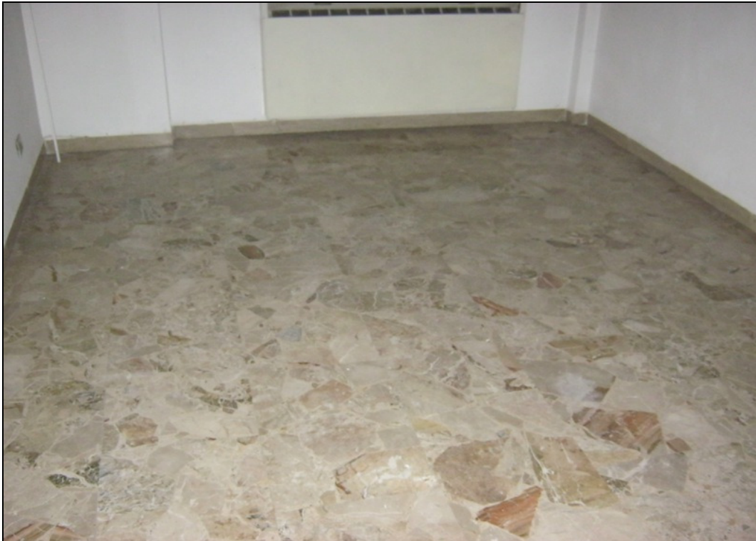
Foto 1 - stato manutentivo pavimentazione del soggiorno e ingresso/corridoio.
