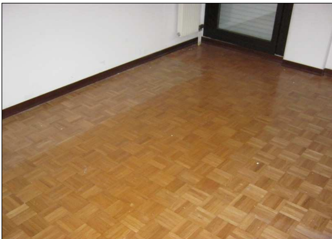
Foto 2 - stato manutentivo pavimentazione delle camere.
