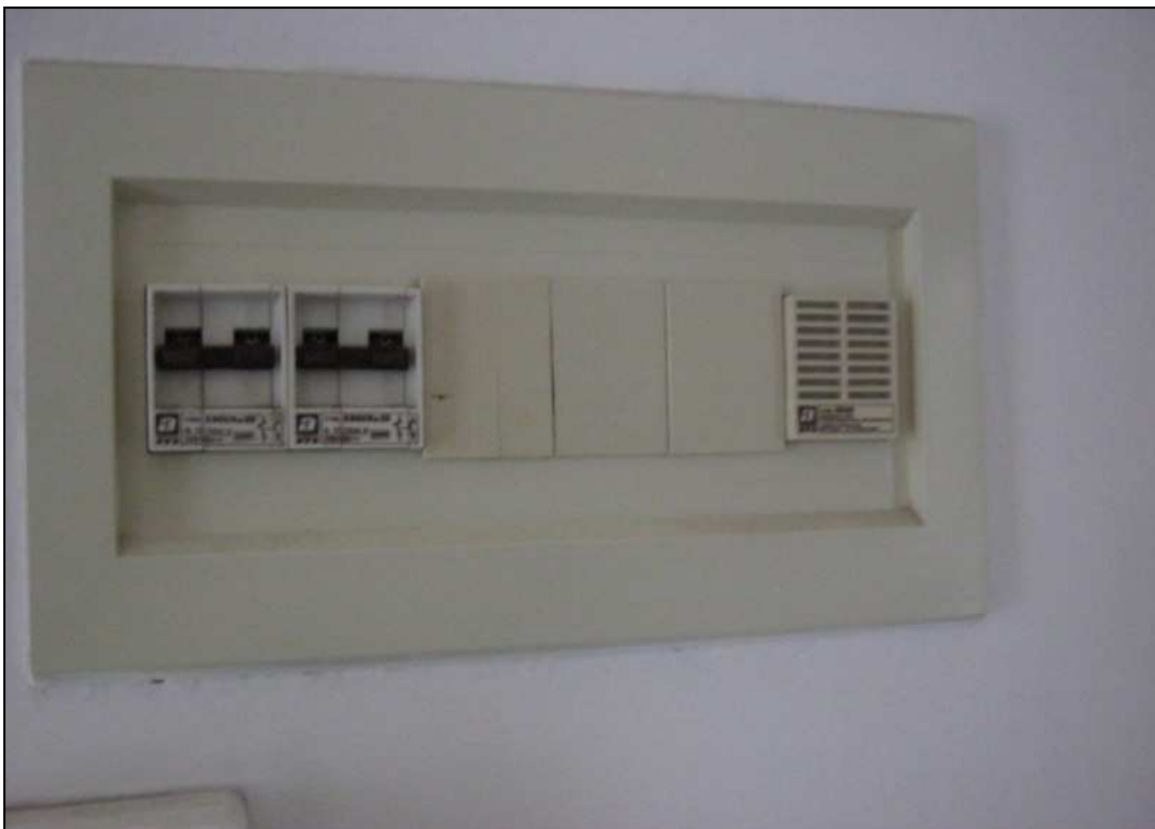
Foto 6 – quadro elettrico unità immobiliare.
