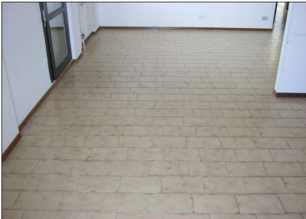
Foto 1 - stato manutentivo pavimentazione della cucina.
