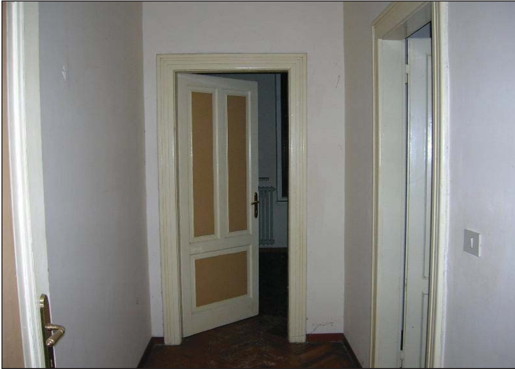
Foto 3 - stato manutentivo pavimentazione camere da letto (parquet).
