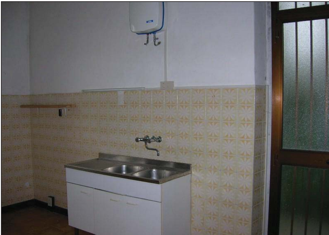
Foto 2 - stato manutentivo pavimentazione locale cucina.
