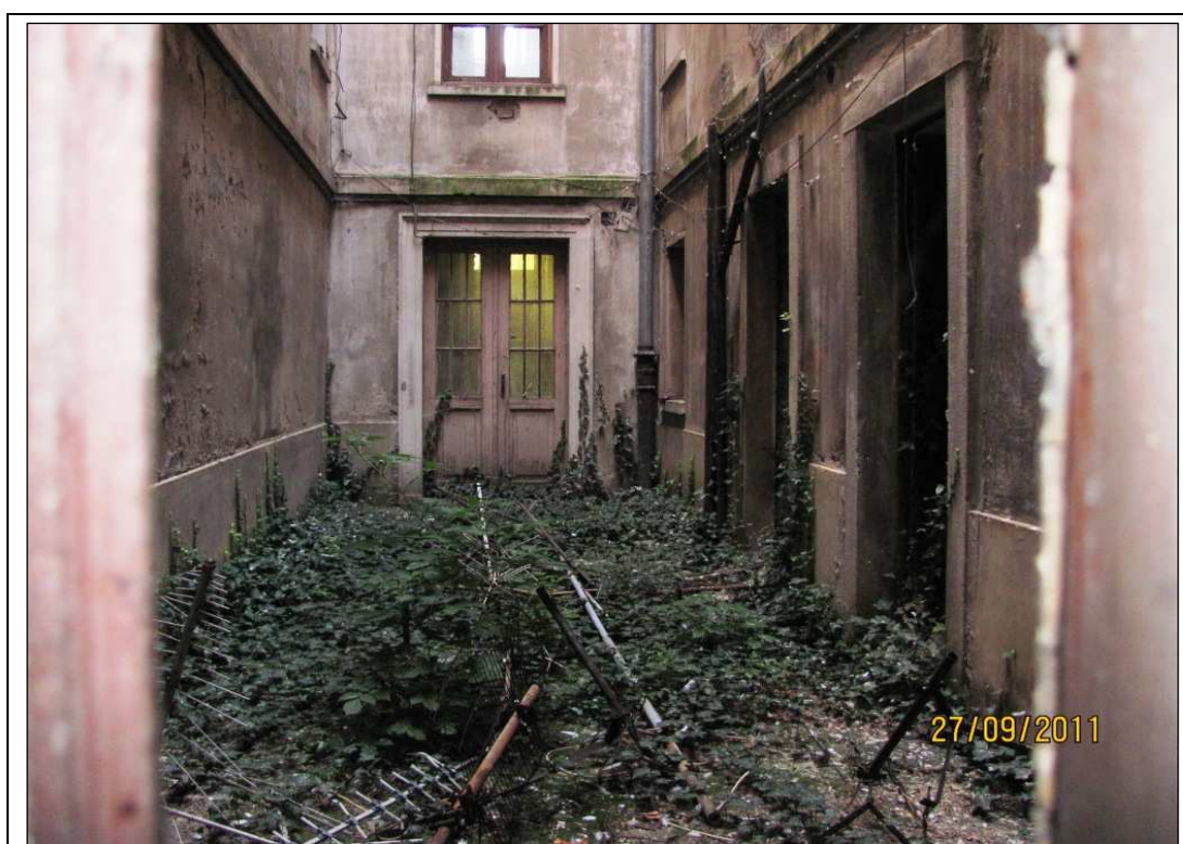
Foto 10 – particolare fotografico dove si evidenzia il degrado generale cortile interno.
