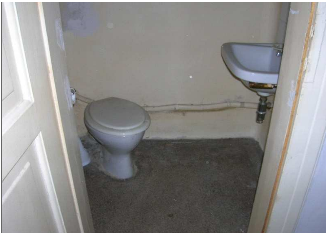
Foto 3 - stato manutentivo pavimentazione del bagno.
