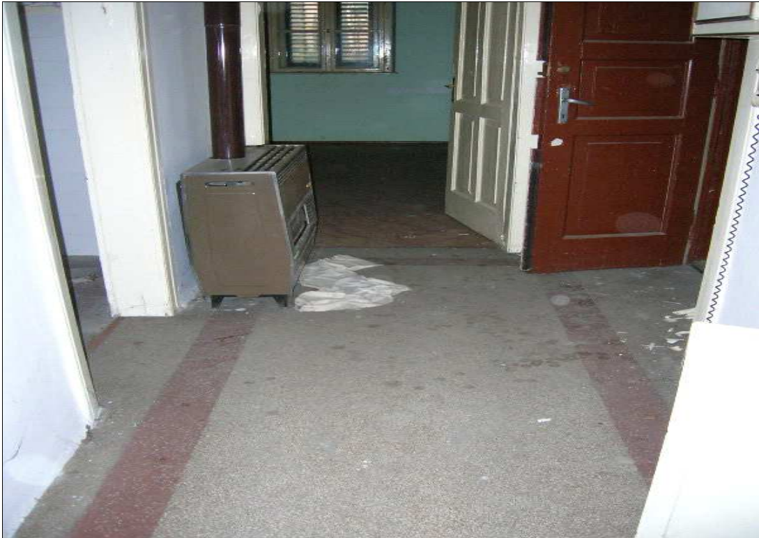
Foto 1 - stato manutentivo pavimentazione dell'ingresso / corridoio e soggiorno.
