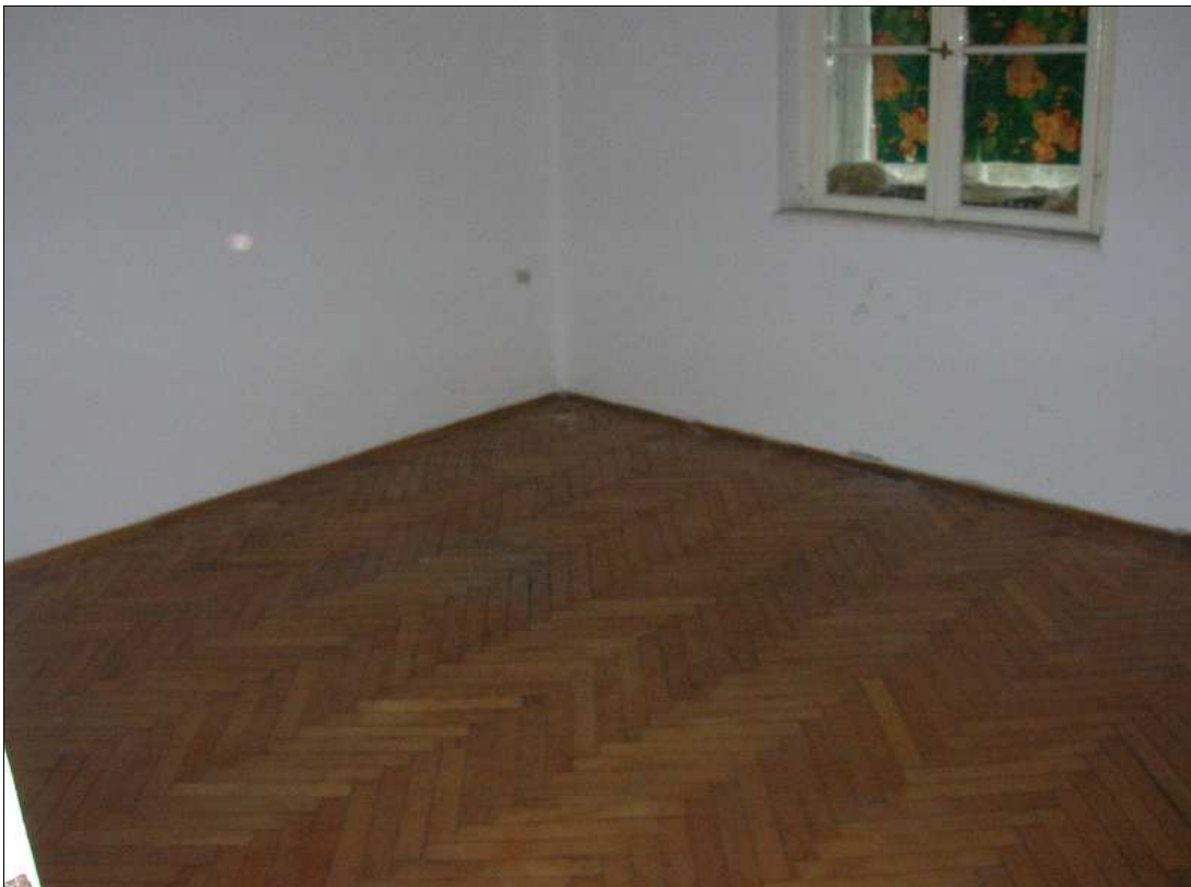
Foto 2 - stato manutentivo pavimentazione e pareti delle camere.
