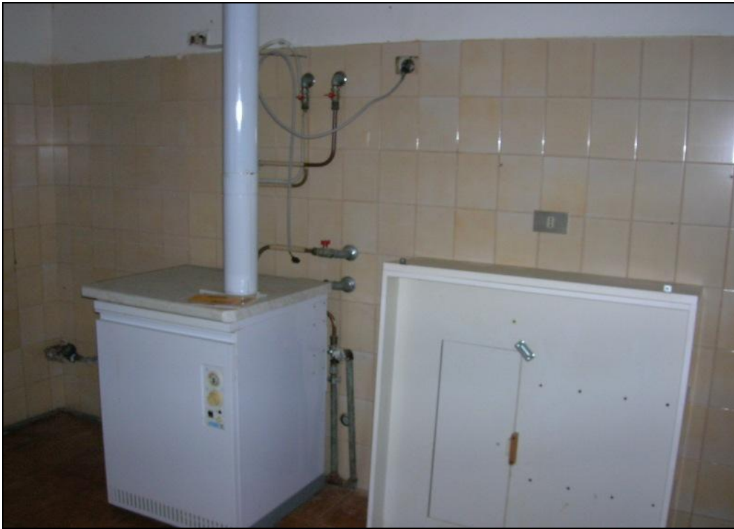
Foto 7 - caldaia dell'impianto di riscaldamento autonomo a metano.
