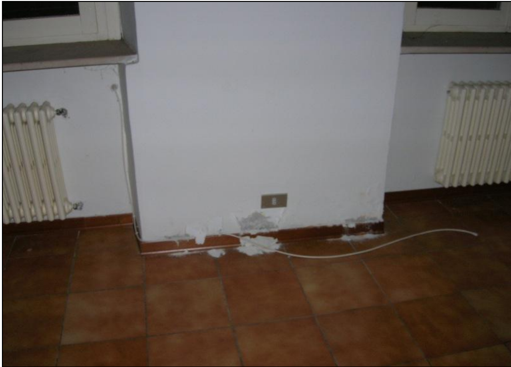
Foto 1 - stato manutentivo pavimentazione dell'ingresso/corridoio.
