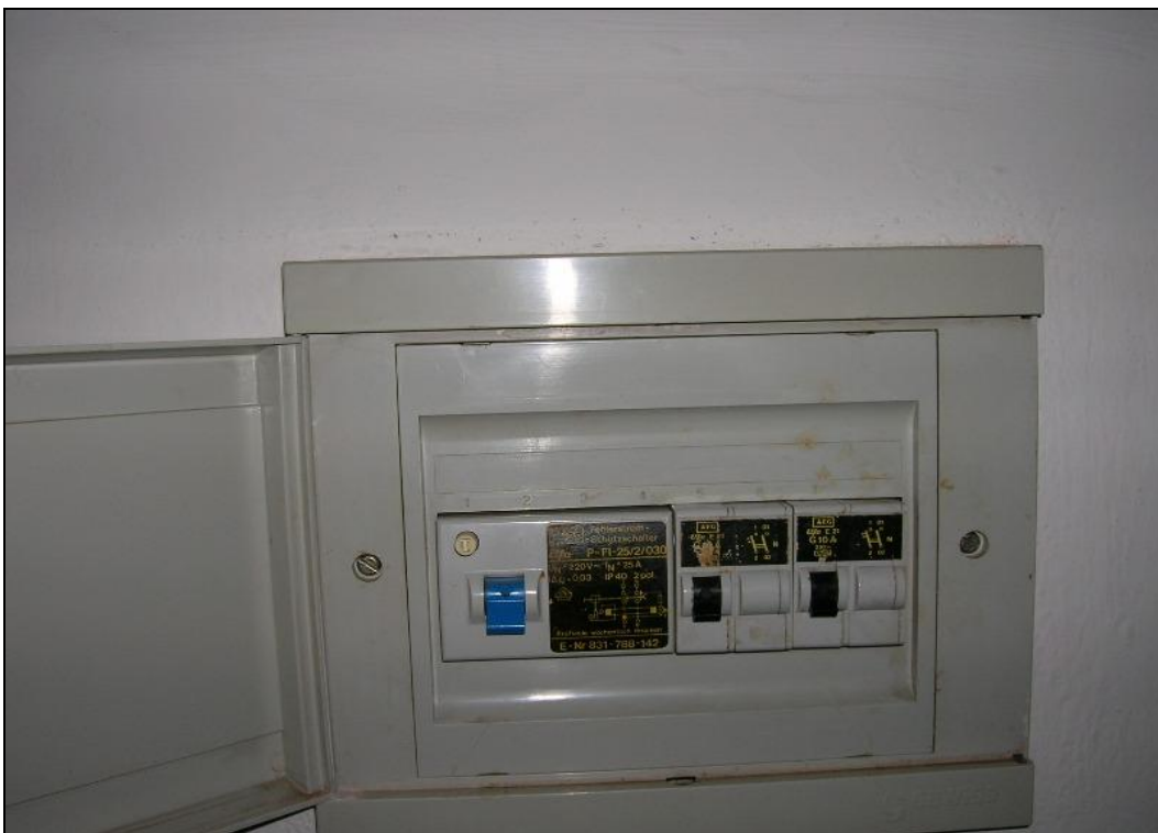
Foto 6 – quadro elettrico dell'unità immobiliare.
