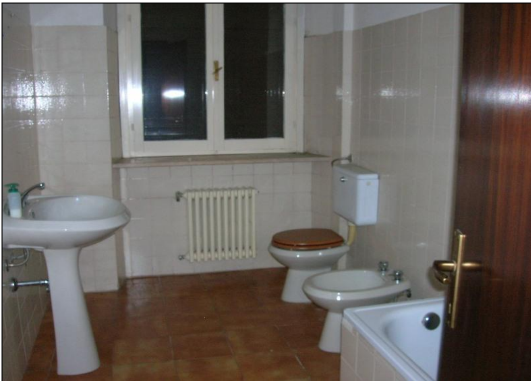
Foto 2 - stato manutentivo pavimentazione del bagno.
