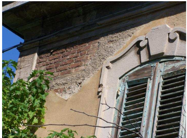
12 Particolare degrado prospetto
