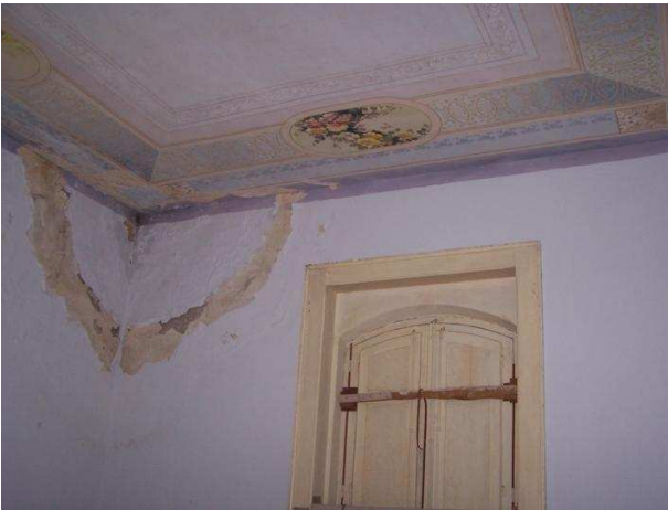
21 Piano rialzato – infiltrazioni acqua
