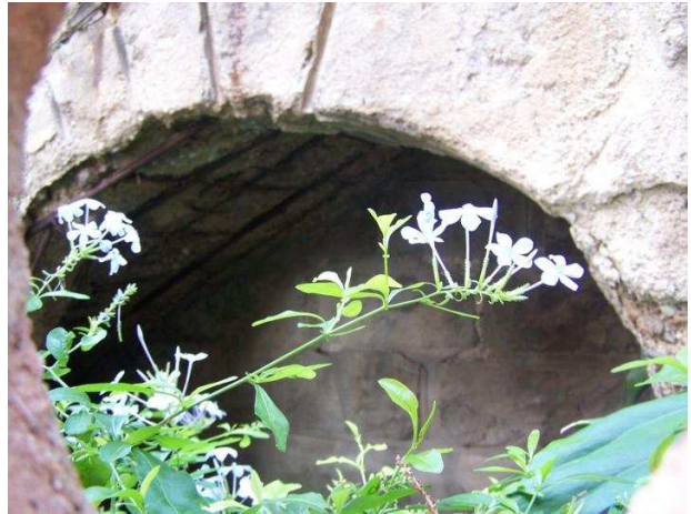
8 Particolare degrado ferri armatura scala ingresso
