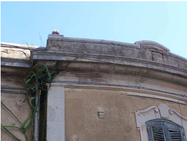
11 Particolare degrado prospetto
