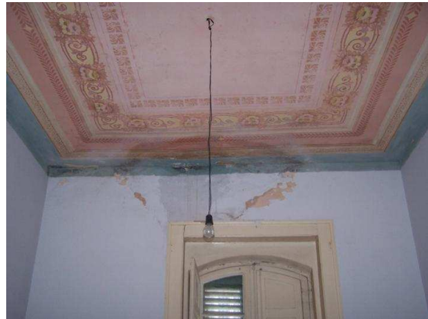
22 Piano rialzato – infiltrazioni acqua
