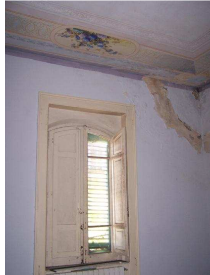
20 Piano rialzato – finestra e parete compagnatura
