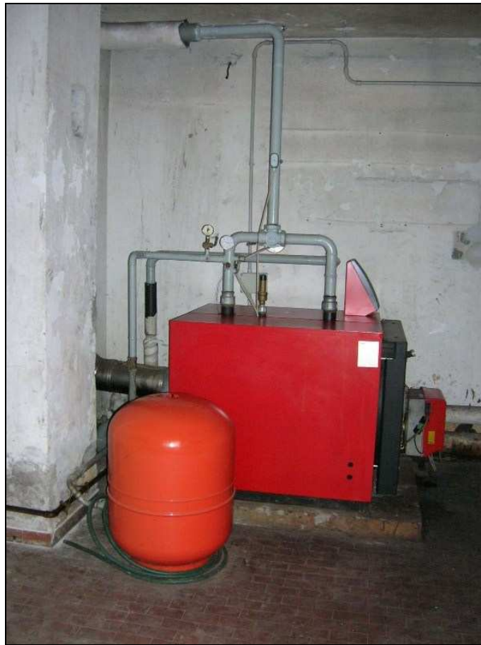
Foto 7: centrale termica centralizzata.
