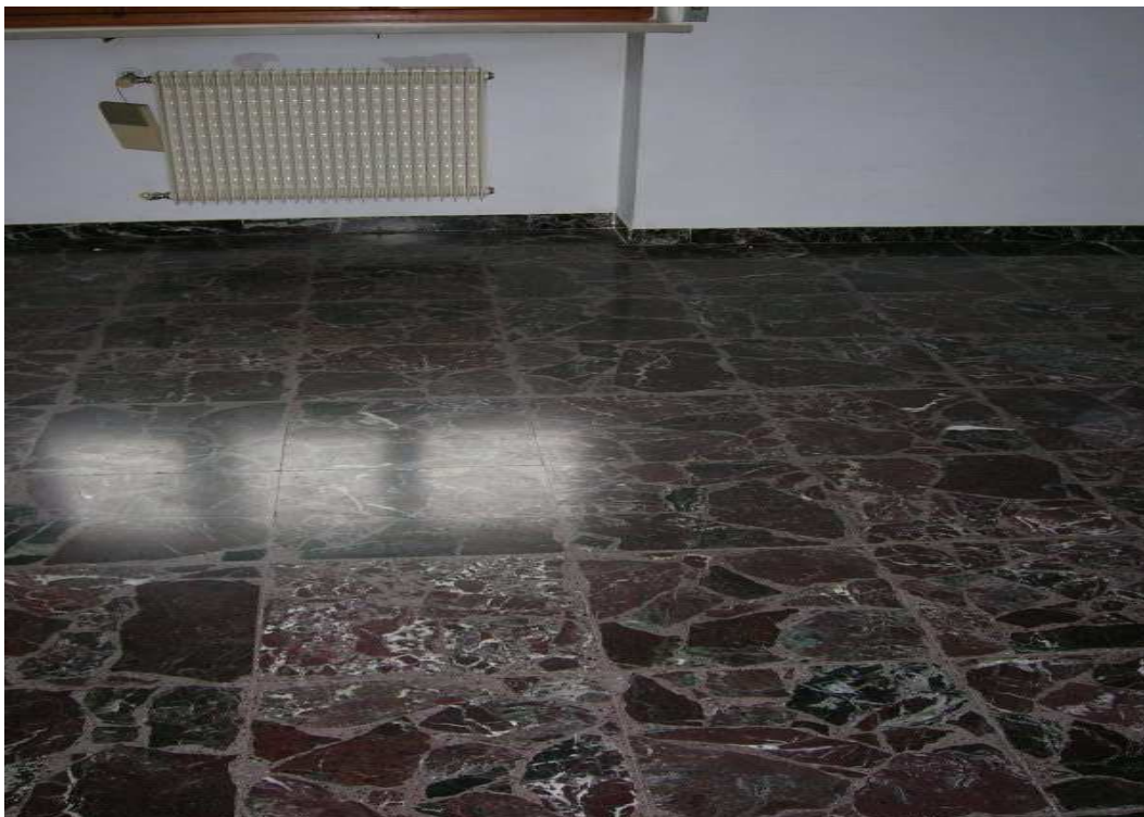
Foto 4: stato manutentivo pavimentazione soggiorno.
