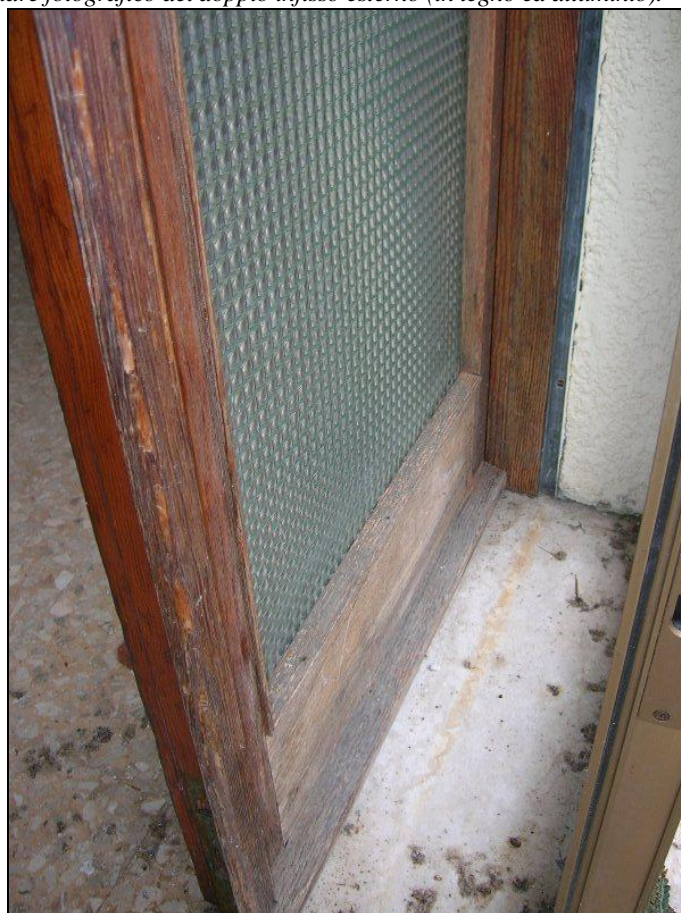
Foto 12 - Particolare fotografico del pessimo stato dell'infisso esterno in legno.
