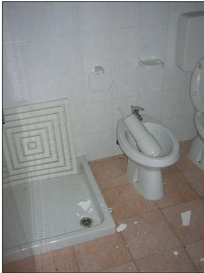
Foto 3: stato manutentivo pavimentazione e rivestimento del bagno.
