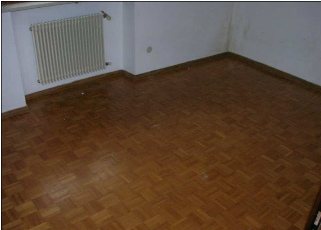
Foto 2: stato manutentivo della pavimentazione in parquet delle camere.
