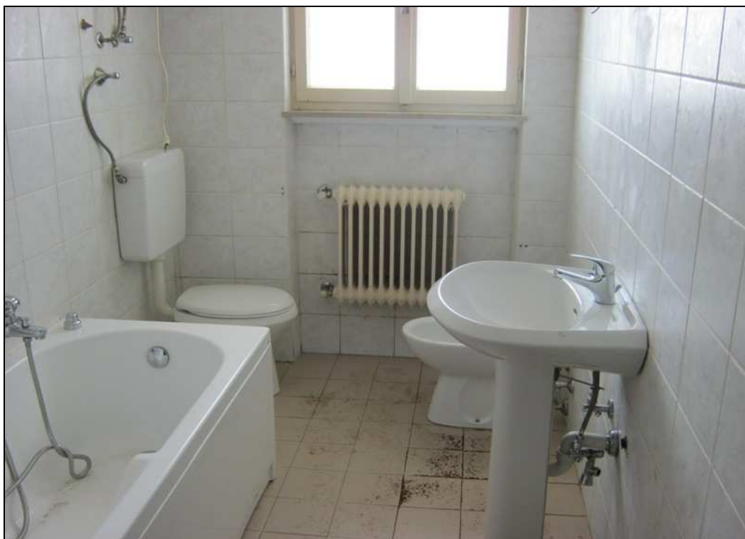
Foto 2 - stato manutentivo pavimentazione del bagno.
