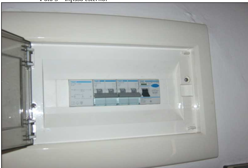
Foto 6 – quadro elettrico unità immobiliare.
