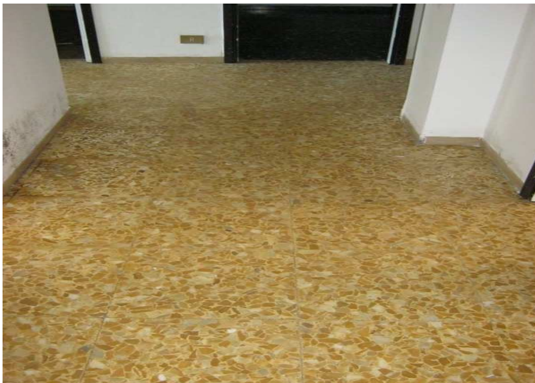
Foto 1 - stato manutentivo pavimentazione dell'ingresso / corridoio e soggiorno.
