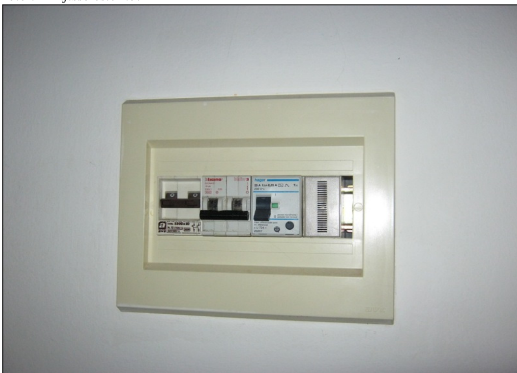
Foto 6 – quadro elettrico unità immobiliare.
