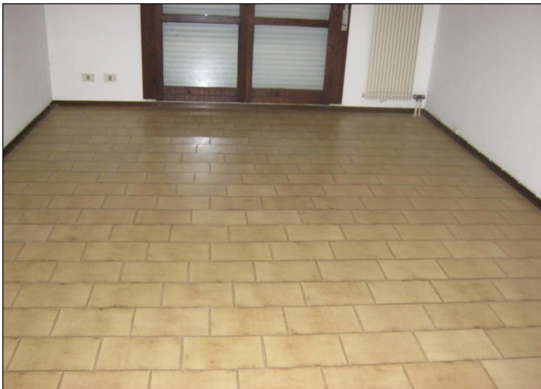
Foto 1 - stato manutentivo pavimentazione dell'ingresso e del soggiorno.
