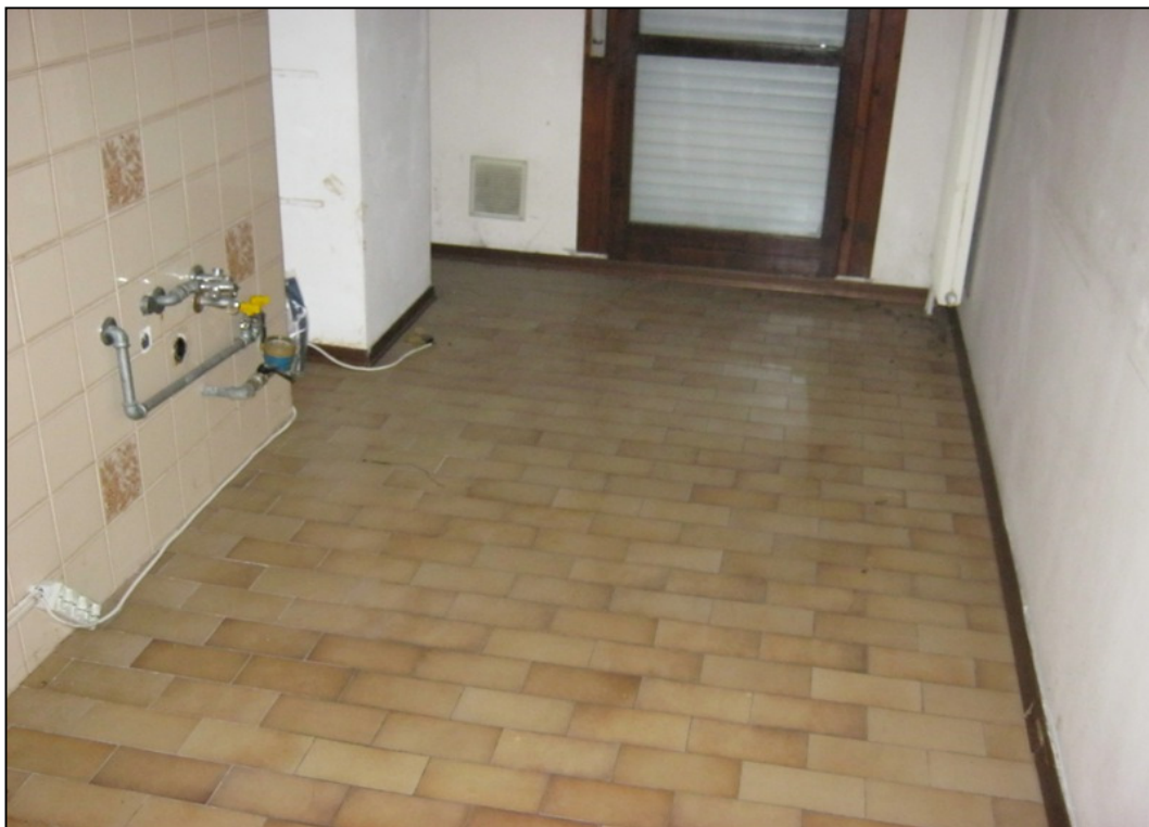
Foto 1 - stato manutentivo pavimentazione della cucina.
