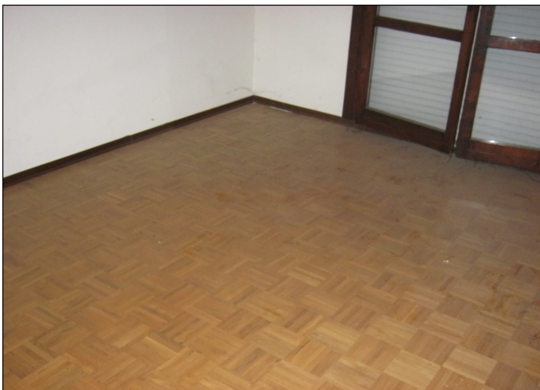
Foto 2 - stato manutentivo pavimentazione delle camere.
