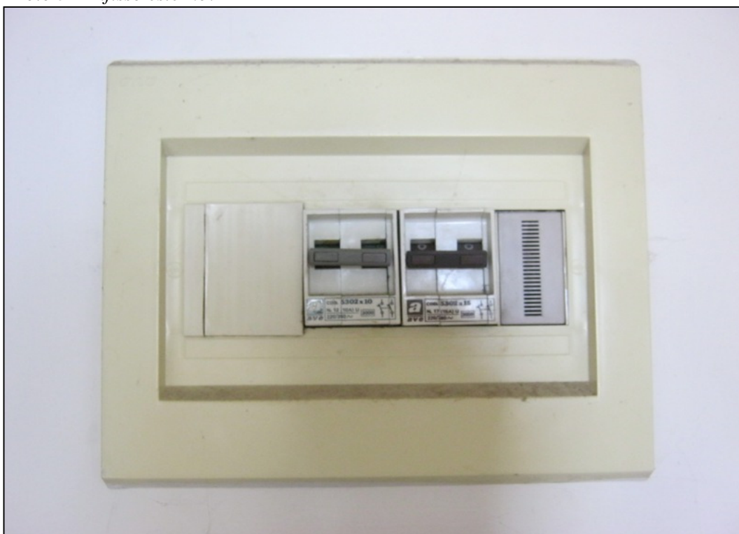
Foto 6 – quadro elettrico unità immobiliare.
